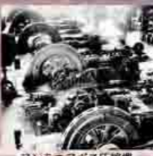
アンモニアガス圧縮機
